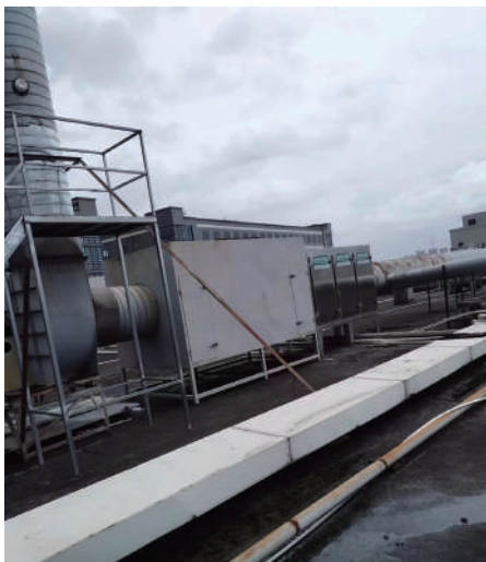
東莞富陽廠廢氣處理：二級活性炭箱
